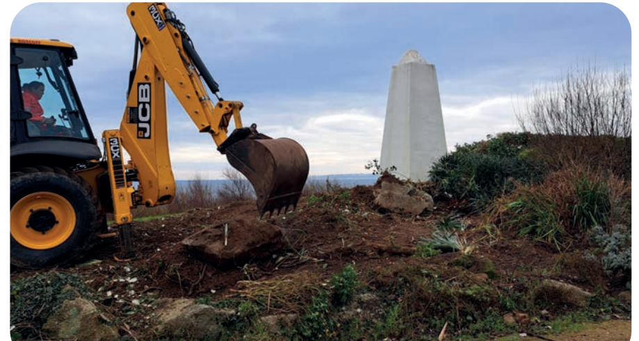
Arrachage mécanique à l'aide d'une pelleuse près de l'amer non loin de la chapelle Sainte-Barbe - 2025
