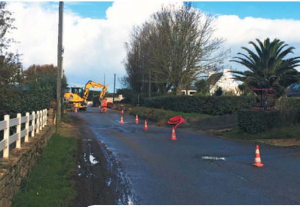
Route de Perharidy : les travaux de réfection et d'effacement des réseaux s'achèvent, reste l'aménagement de la voirie
